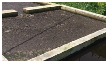
Figura 3 | Tanque sin aireador para proceso, Presencia de grasas, nata, material flotante y mal olor.
