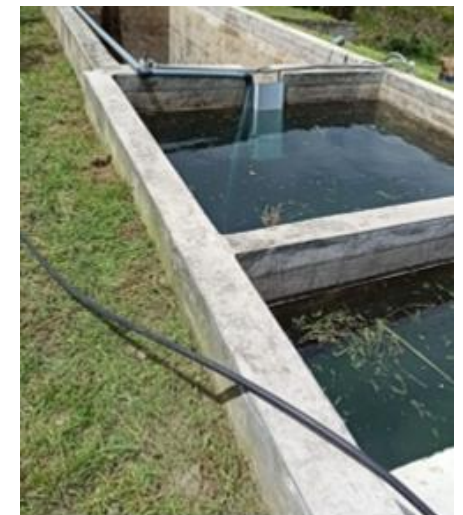
Figura 13 | Implementación de sistema deflector al ingreso y salida del tanque sedimentador primario.
