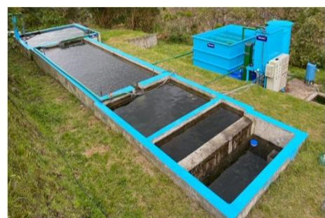
Figura 15 | Planta de tratamiento en óptimas condiciones de funcionamiento.
