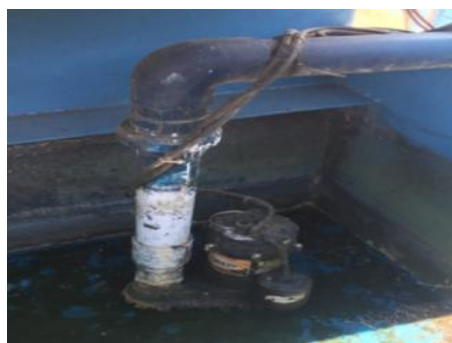
Figura 5 | Bombas sumergibles echadas a perder por falta de mantenimiento.
