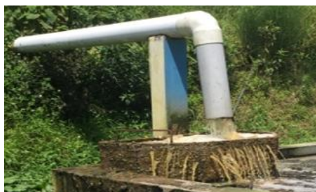
Figura 2 | Tamiz de retención y en mal estado, Acumulación de sólidos por falta de limpieza y mantenimiento.
