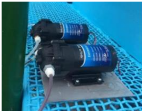
Figura 10 | Colocación de bombas de dosificación química.
