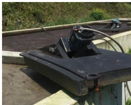
Figura 4 | Daño en las aspas Por presencia de huesos, aireador superficial deteriorado.
